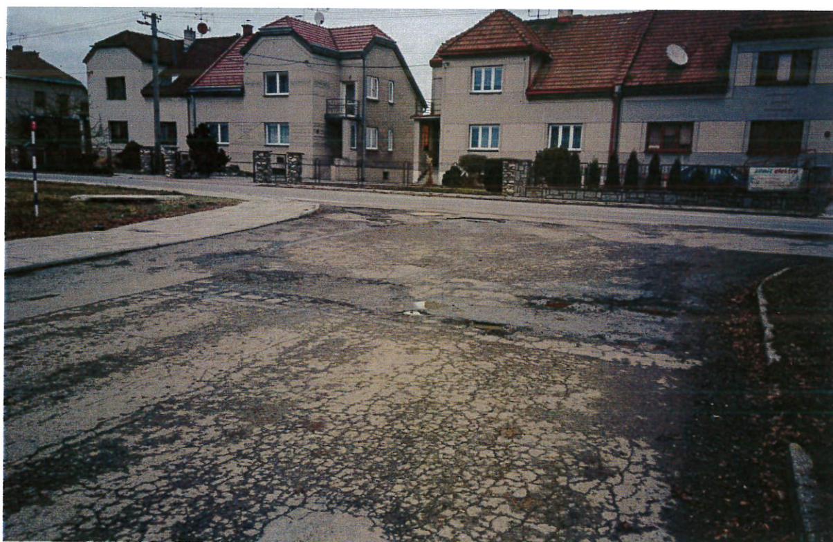
Vjezd z místní komunikace na III/43415 – propadlá vozovka nad kanály
