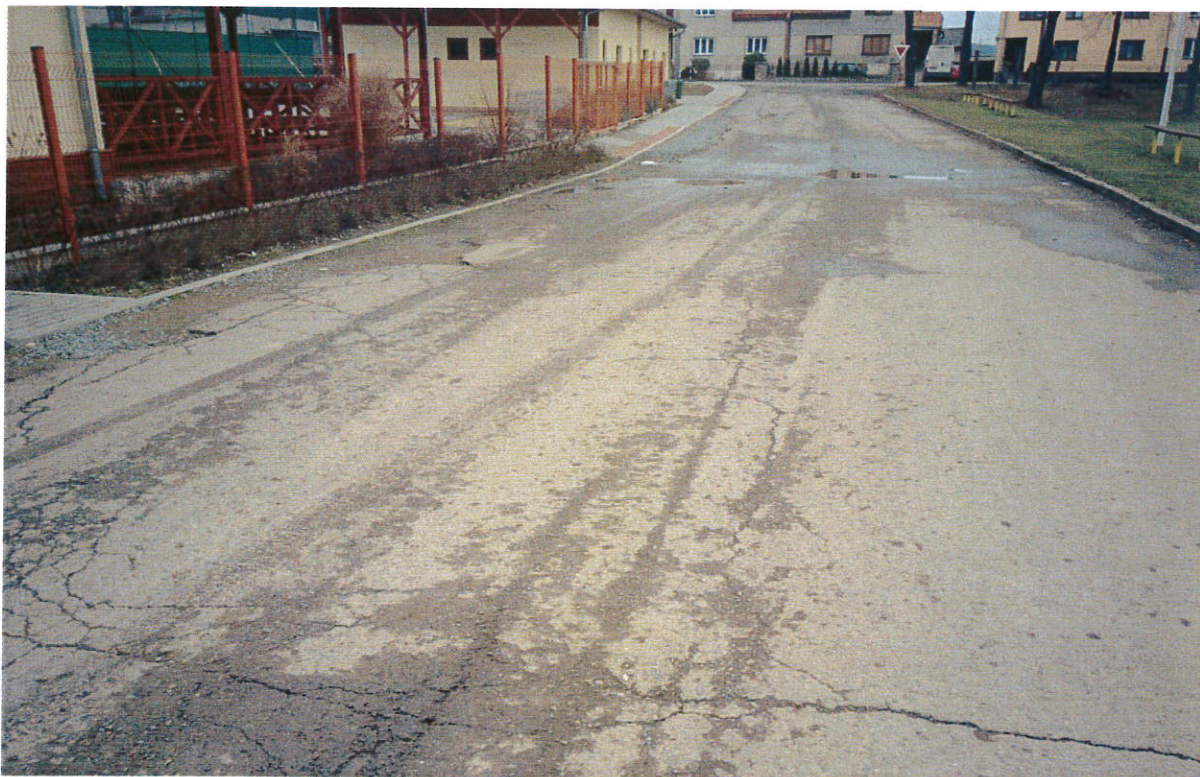
Porušená vozovka místní komunikace
